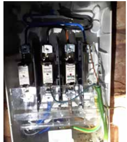
► Lebensgefährliche Stromabnahme vor dem Stromzähler
